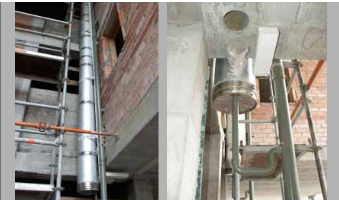
Foto 38: Recogida de condensados, con conexión mediante sifón a saneamiento, en la parte inferior de una chimenea modular metálica de doble pared de acero inoxidable, para calderas estancas. Se observa la conexión para el conducto de evacuación de humos, protegida mediante un plástico, para evitar la entrada de cuerpos extraños durante la obra. Junto a la chimenea se ve el conducto de plástico para la campana extractora. Fabricante DINAK .
