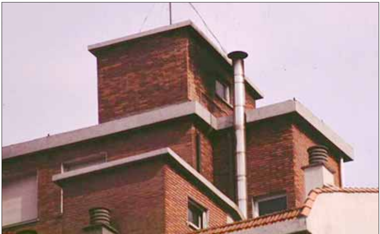
Foto 55: Chimenea de caldera central, insuficientemente elevada sobre los obstáculos colindantes, además el remate impide la correcta dispersión de los humos, incrementando el riesgo en los locales próximos.
