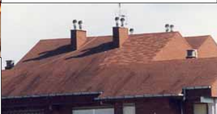
Foto 58C: Remates de ventilación con los aspiradores dinámicos metálicos.
