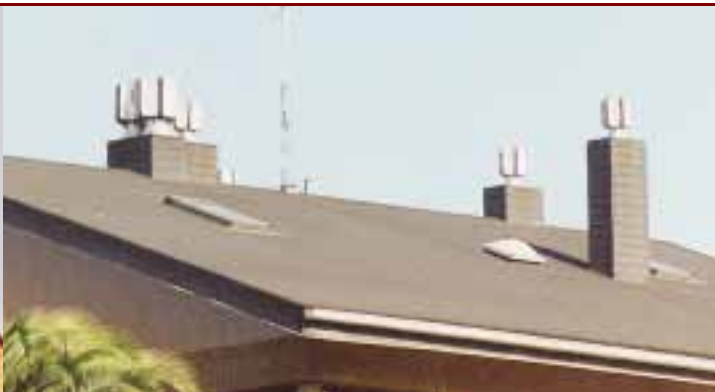
Foto 58B: Remates de ventilación con los aspiradores estáticos metálicos.
