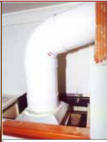
Foto 60: Conducto de humos de material metálico liso correcto; el codo es de 72° lo que resulta óptimo para estas aplicaciones.
