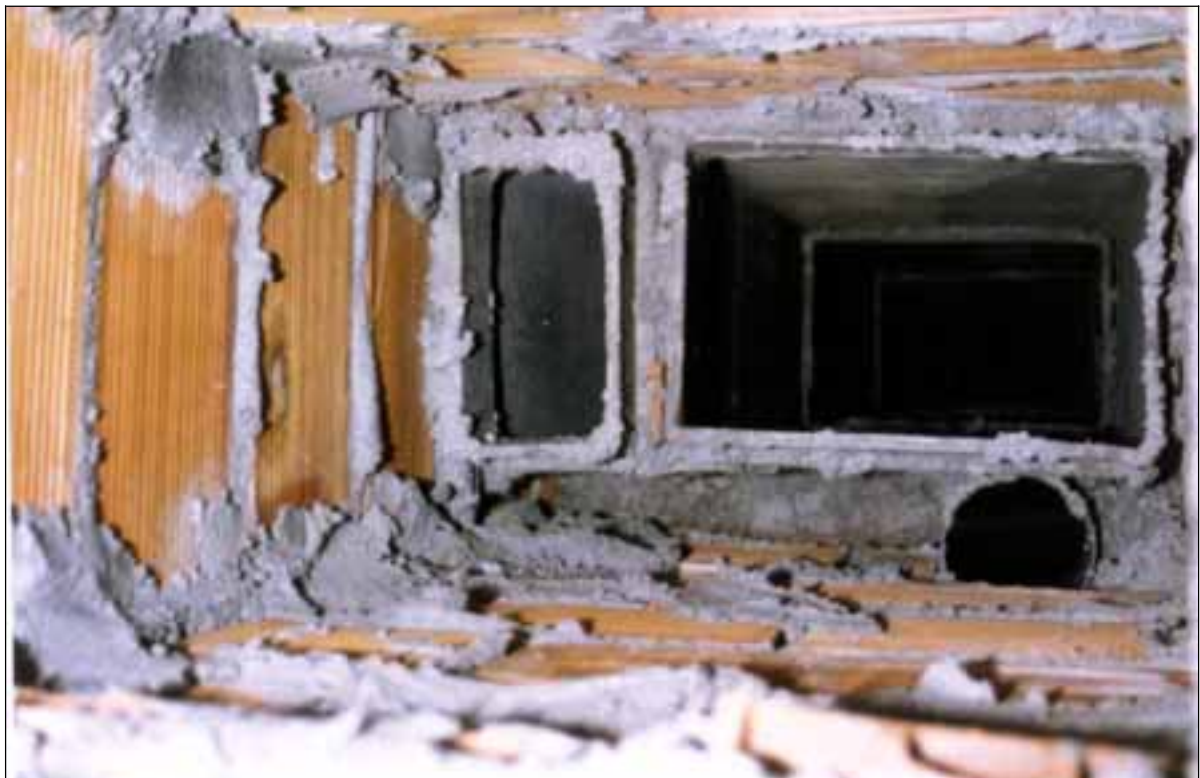
Foto 44: Chimenea para edificio de 5 alturas; material adecuado ISH con piezas machiembradas que garantizan la estanqueidad y evitan restos de masa interior. Falta otro conducto individual y, además, la chimenea no alcanza la base del aspirador estático.
