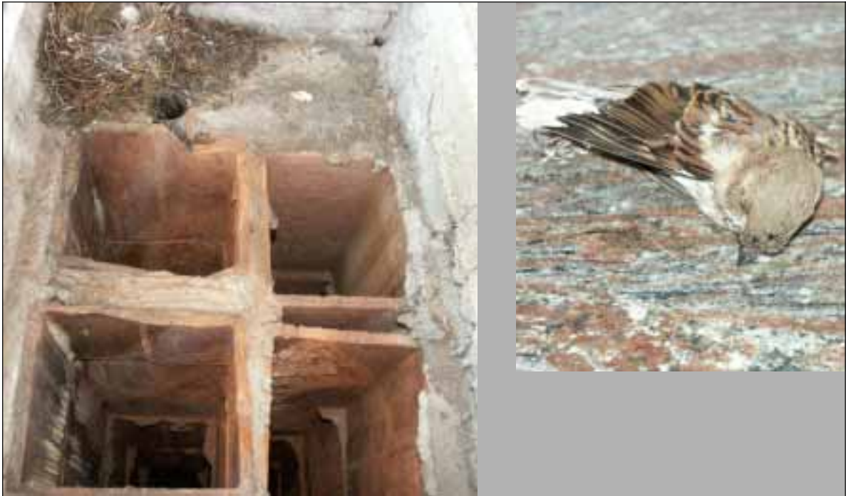
Foto 37: Remate en cubierta de un conjunto de chimeneas individuales de material cerámico, inadecuado para este uso. En la parte superior izquierda se ve un nido de pájaros; esta situación, que es habitual, a veces ha provocado graves accidentes por carecer de fondo de saco en el arranque de la chimenea, lo que ha llevado a la obstrucción del conducto de evacuación de humos, a la izquierda se muestra un pájaro extraído de una chimenea.
