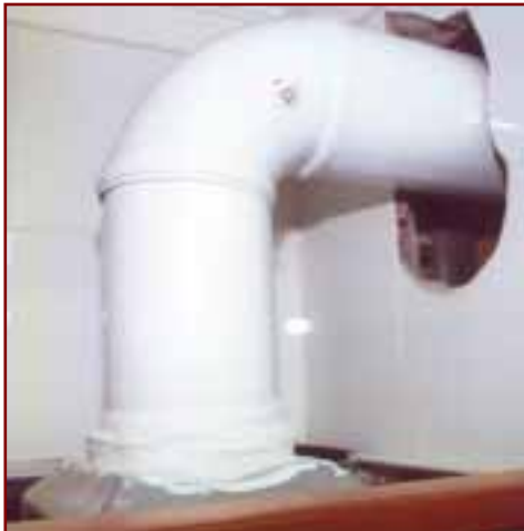
Foto 59: Conducto de humos de material metálico liso correcto; el codo es de 87° lo que permite mantener la pendiente mínima del 3%.
