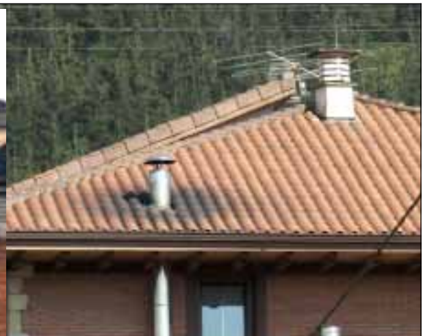
Foto 57B: Ensuciamiento de la cubierta del edificio debido a los problemas de dispersión de humos por el remate de la chimenea.
