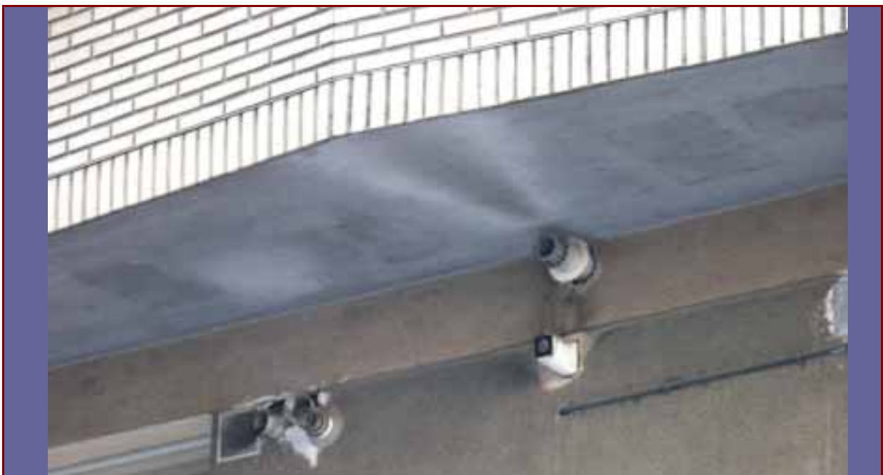
Foto 64: Caldera estanca con evacuación por fachada, el penacho de humos ha dejado marca en el vuelo de la terraza superior, en estas condiciones los humos se pegaran a la fachada ascendiendo a lo largo de la misma y creando molestias en las plantas superiores.
