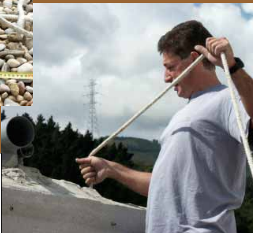
Foto 45: Comprobación de la ausencia de obstrucciones en chimeneas de obra, dejando caer una pieza de dimensiones ligeramente inferiores a las de la chimenea.
