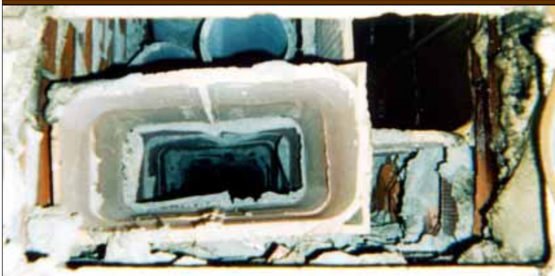
Foto 42: Chimenea para edificio de 4 alturas; material inadecuado ISV sección incorrecta, con restos de masa en las uniones; el conjunto incluye los conductos de las extractoras, lo que incrementa las dificultades de una correcta evacuación de humos.
