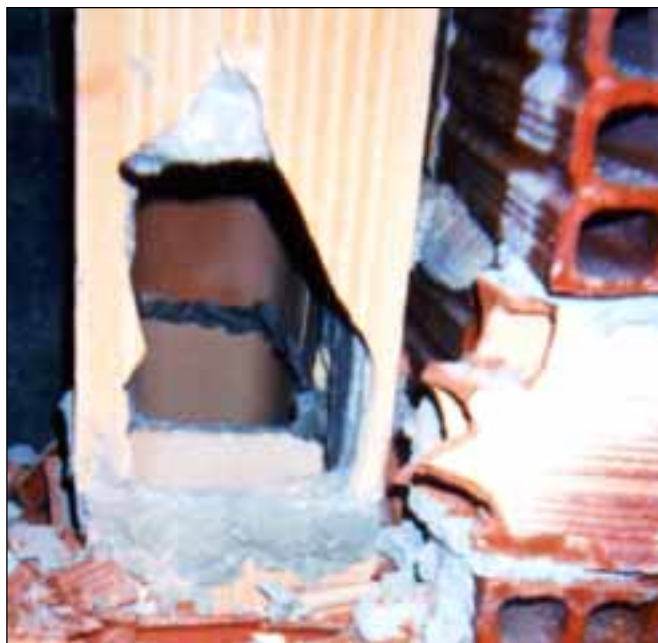
Foto 47: Chimenea de la Foto 42 en su paso por la planta bajo cubierta; únicamente dispone de 2 conductos para las 4 viviendas, además en esta planta el correspondiente a la última caldera se une al conducto general, sin el preceptivo tramo equivalente a una planta.
