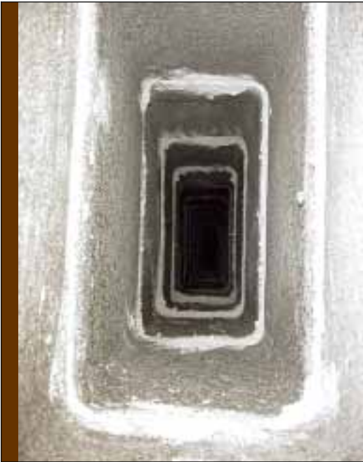
Foto 51A: Chimenea de obra realizada con hormigón, de dimensiones diferentes a las especificadas en la NTE-ISH/74; la ejecución y el control de obra ha sido muy bueno..
