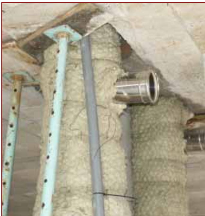
Foto 53: Chimeneas colectivas de simple pared de acero inoxidable, antes de tabicar se deben aislar térmicamente; en la parte superior se ven los emboques para los conductos de humos de las calderas de cada mano de viviendas. Fabricante DINAK .
