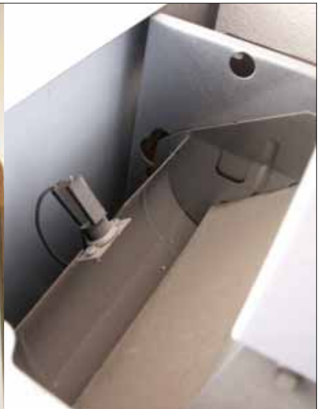
Foto 3B: Dispositivo antirrevoco de humos, situado en el cortatiros de la caldera.
