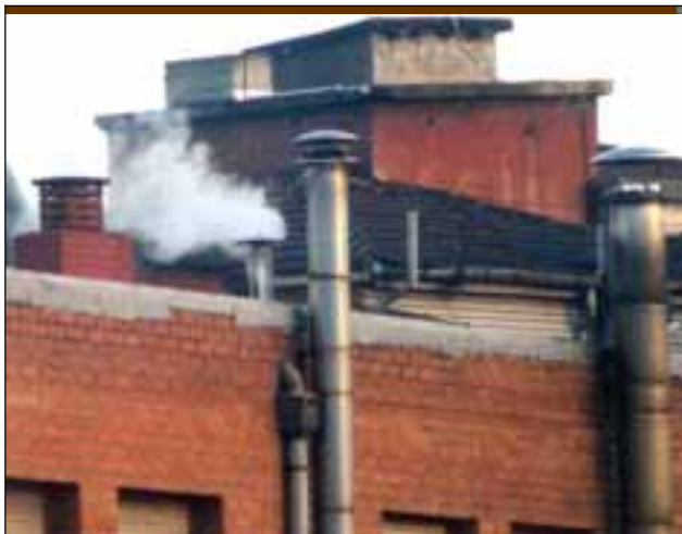
Foto 57A: Efecto del remate de chimenea en la dispersión de humos; se puede comprobar como este tipo de remates perjudica la correcta elevación del penacho.
