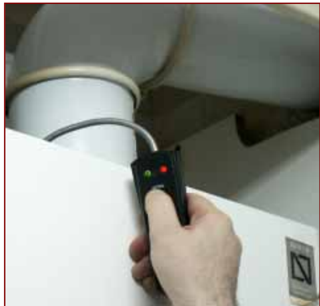
Foto 61: Comprobación del funcionamiento de una caldera atmosférica con analizador de revocos, la sonda se sitúa en el cortatiros de la caldera cuando la misma está en funcionamiento; en caso de revoco se enciende el piloto rojo
