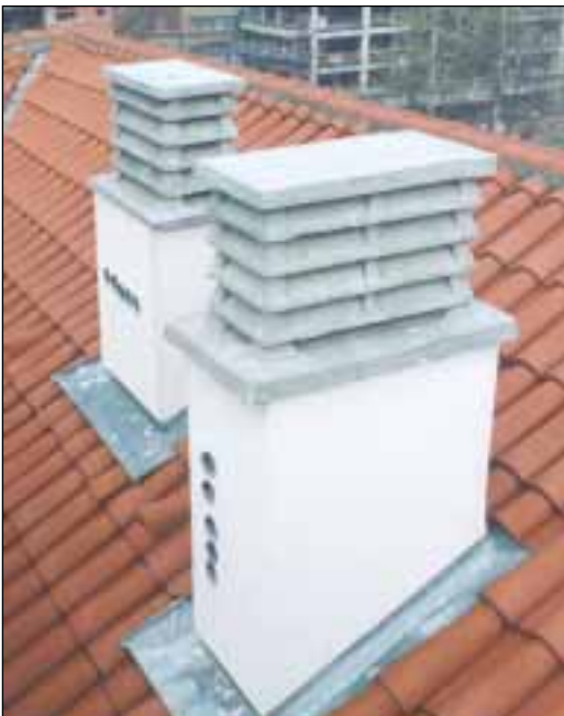
Foto 6: Aspiradores estáticos según NTE-ISH; corresponden a un edificio de 5 plantas. En el frente del conjunto se observan las salidas de los conductos individuales correspondientes a las campanas extractoras
