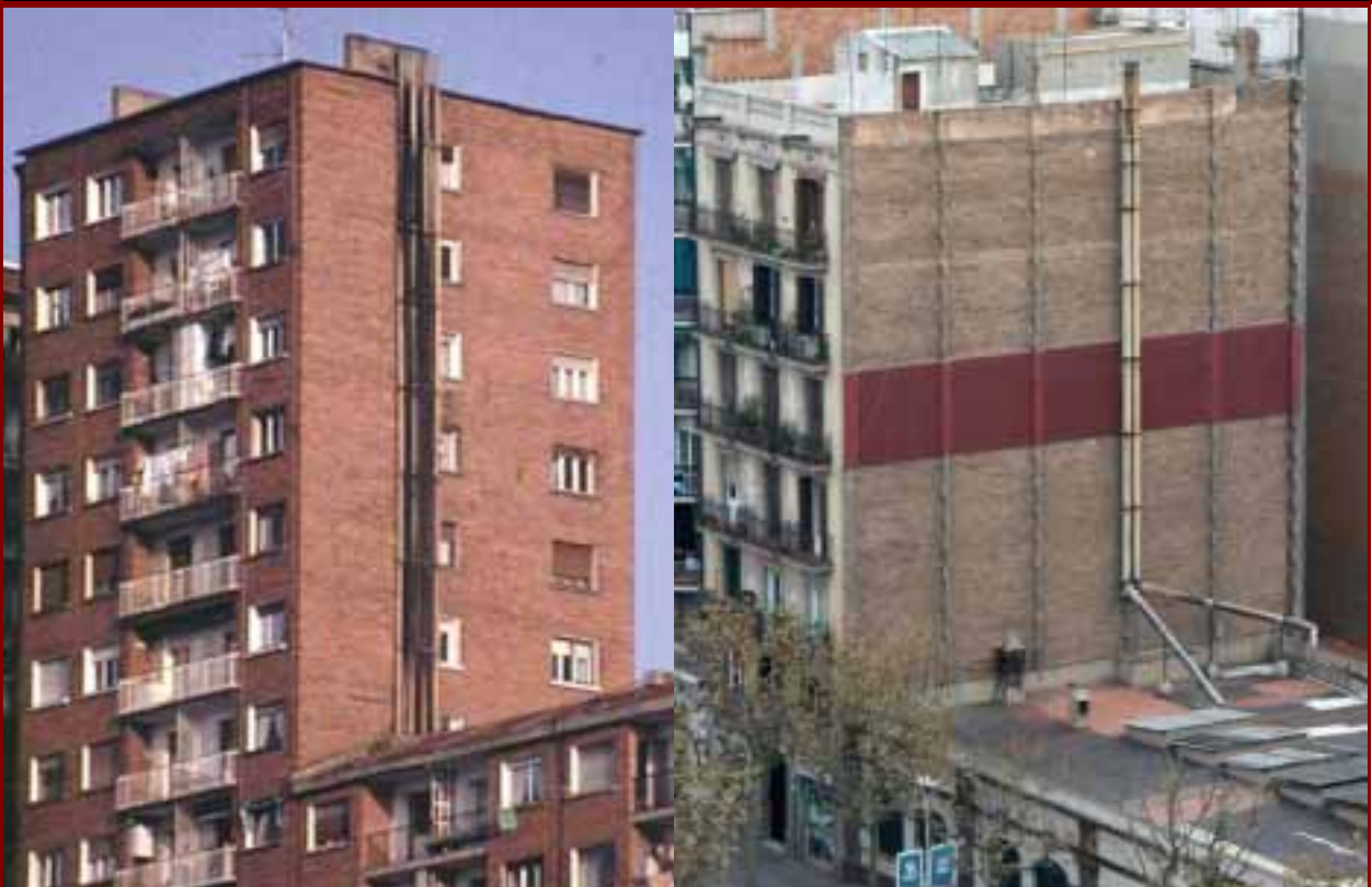
Fotos 23 y 24: Elevación de las chimeneas hasta superar la cumbre del edificio colindante. Esta situación es muy habitual en las ciudades, en las que se permiten construir edificios de mas plantas que los edificios contiguos, ello obliga a elevar las chimeneas de los edificios mas bajos.
