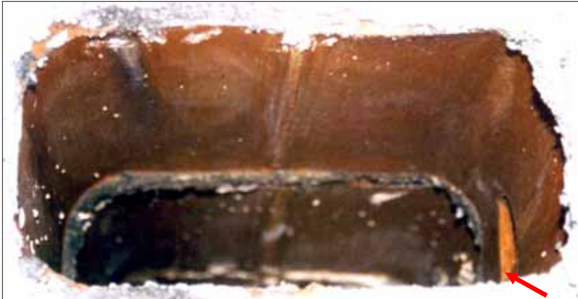
Foto 41: Chimenea para edificio de 5 alturas; material inadecuado ISV con dimensiones insuficientes y único para las 5 plantas; a la derecha se observa la ventilación de la bajante de saneamiento de cocinas.
