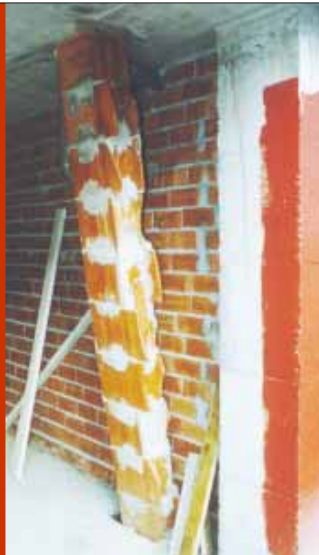
Foto 11: Chimenea Colectiva Cerámica. Material Inadecuado para Humos (NTE-ISV/75).
