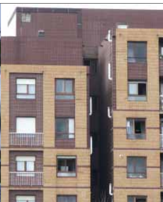
Foto 62B: Evacuación por fachada de calderas atmosféricas, los tramos exteriores han sido prolongados 50cm, conforme a los requisitos del RIGLO.
