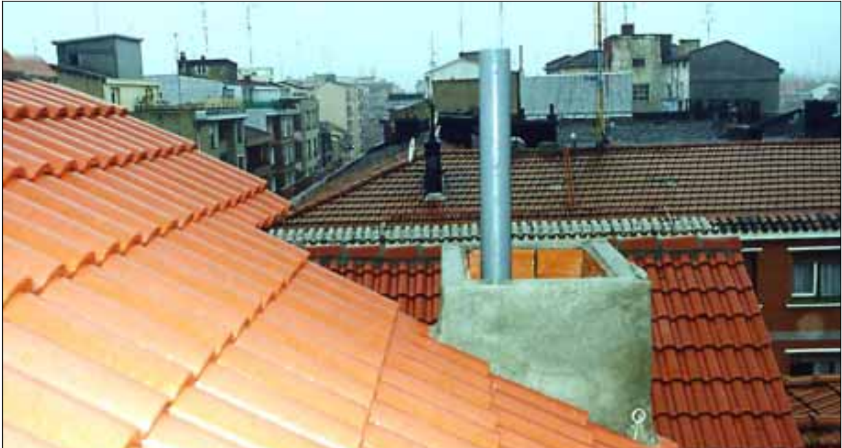
Foto 54: Remate de la chimenea de la Foto 43; ha quedado muy bajo respecto a la cumbre del edificio.
