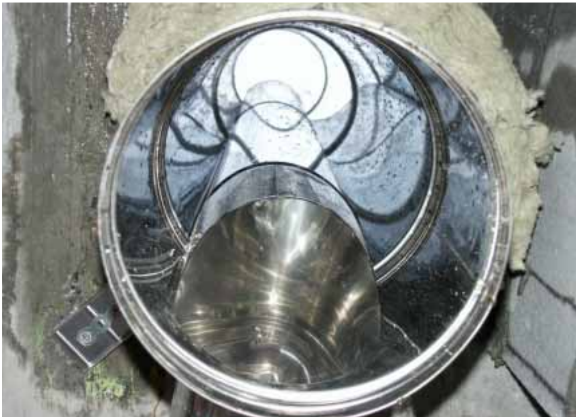
Foto 33: Interior de Chimenea Modular Metálica de simple pared, para calderas Atmosféricas, se observan el Conducto Auxiliar semicircular y el Conducto Común Circular. Fabricante DINAK .
