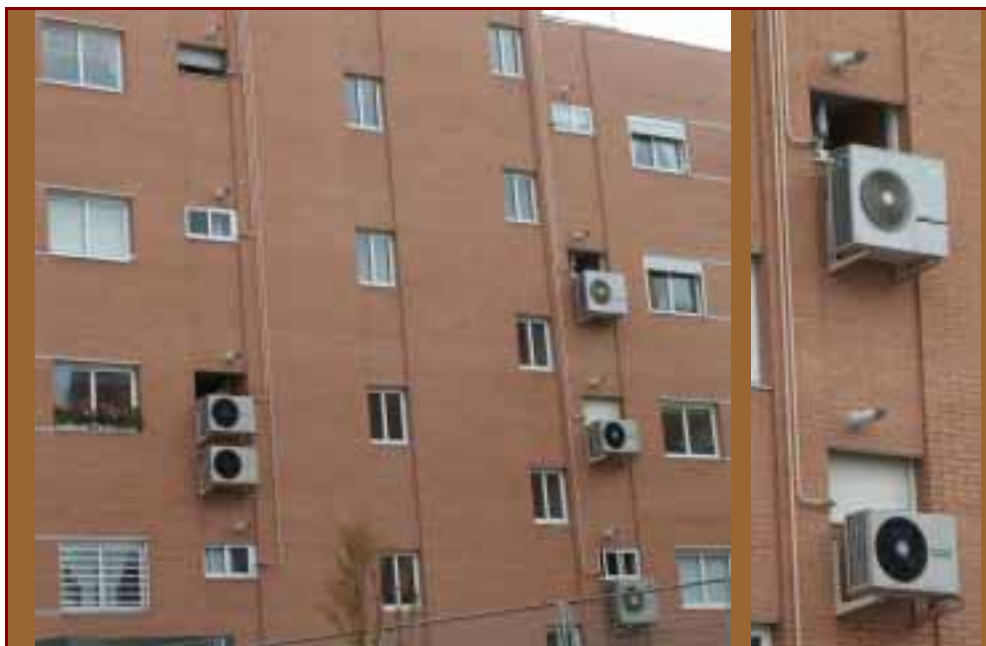
Foto 15A: Edificio de nueva construcción con evacuación de humos por fachada exterior. Las calderas han sido ubicadas en los tendederos, no hubiese sido difícil resolver la evacuación hasta cubierta.
