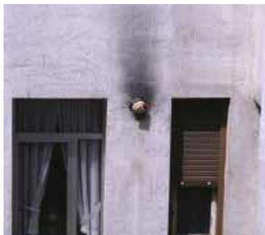
Foto 63: Evacuación por fachada de caldera atmosférica, conforme a los requisitos del RIGLO se ha instalado un deflector; claramente esta solución es inadecuada.
