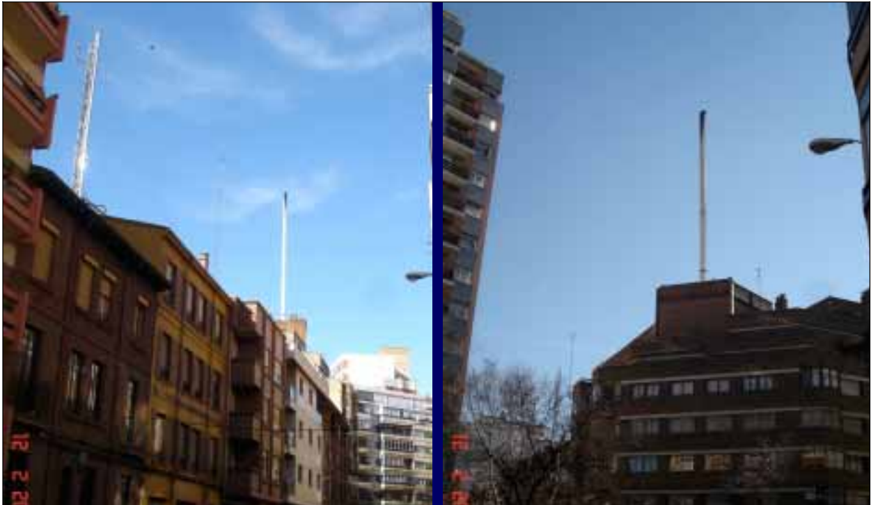
Fotos 56C y 56D: Chimeneas de calderas centrales, elevadas por encima de los edificios colindantes, en una se ha dispuesto una estructura para garantizar su estabilidad, mientras que la otra presenta grave riesgo de desplome.
