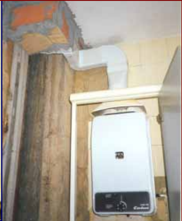
Foto 26: Conducto de Humos de material Plástico inadecuado, sección y trazado (excesivos cambios de dirección) Absolutamente Inadmisible.
