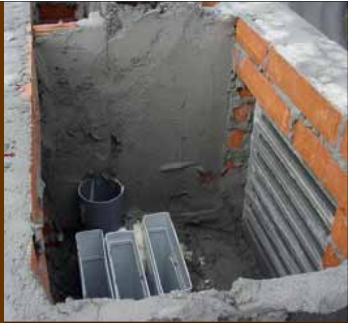
Foto 51B: Remate de cubierta del conjunto de ventilación: Chimenea Colectiva, Ventilación Superior Colectiva, Extractoras individuales. Separación entre las extractoras y resto de servicios, con rejilla lateral para las mismas.
