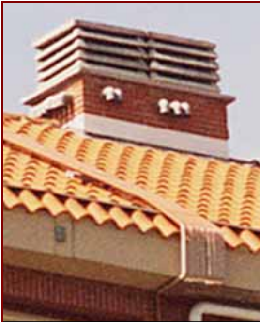
Foto 58A: Remate del conjunto de ventilación con los aspiradores estáticos según las especificaciones de la norma NTE, se observa como las campanas extractoras han sido volteadas para evitar la interferencia del tiro forzado en el remate.
