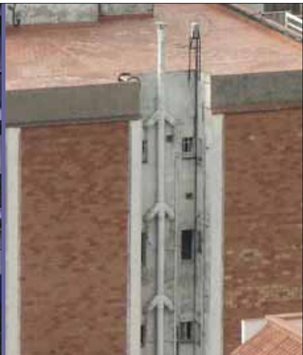
Foto 66: Evacuación por cubierta en edificación existente; el material fibrocemento no es apropiado. La instalación es anterior a la aprobación del RIGLO y, por supuesto de las normas UNE 123.001 y 60.670/99; lo que supone una aplicación interesante y una clara mejora a la evacuación por fachada.
