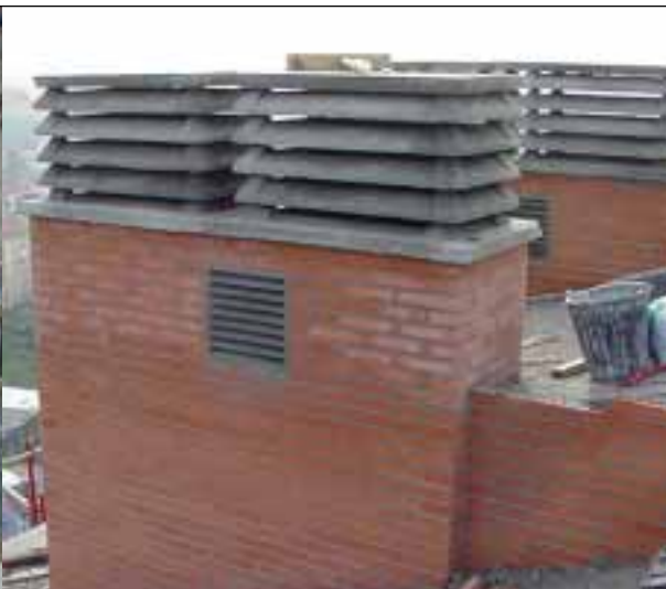
Foto 51D: Remate de cubierta del conjunto de ventilación: Chimenea Colectiva, Ventilación Superior Colectiva, Extractoras individuales. Separación entre las extractoras y resto de servicios, con rejilla lateral para las mismas. Conjunto finalizado, en los laterales hasta la base de los aspiradores estáticos se encuentran las ventilaciones naturales (chimenea y superior) y en el centro, con salida por dos rejillas opuestas, las extractoras.
