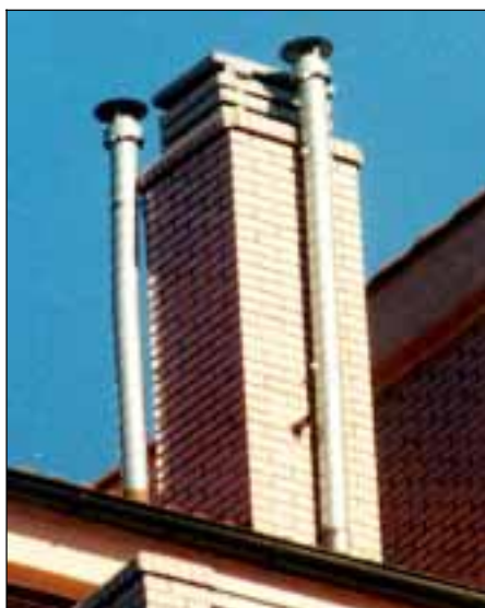
Foto 48: Edificio de 6 plantas. Ha sido necesario realizar dos conductos independientes para las últimas plantas, sin duda obligado por problemas de funcionamiento en la puesta en marcha. El material utilizado para estos conductos, galvanizado, no es adecuado para evacuación de humos.
