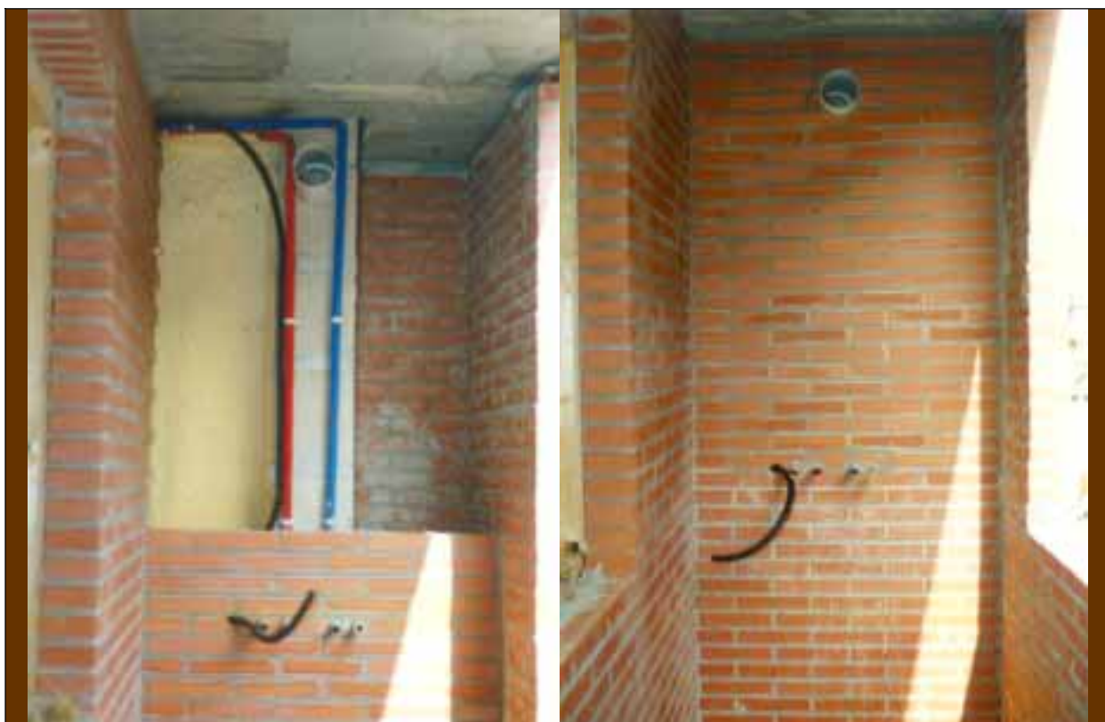
Foto 40: Chimenea según NTE-ISH, antes y después de tabicar; la instalación previa de la plantilla de la caldera ha permitido situar con exactitud los puntos de conexión de las tuberías y, lo que es fundamental, del conducto de humos.
