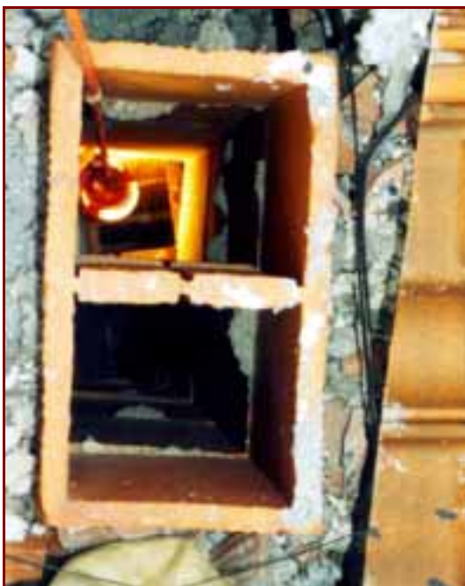
Foto 16: Chimenea correspondiente a un edificio de 3 plantas. Material inadecuado, sección incorrecta y ejecución muy defectuosa; se puede comprobar como las piezas han sido giradas, perdiendo estanqueidad y sección de paso.
