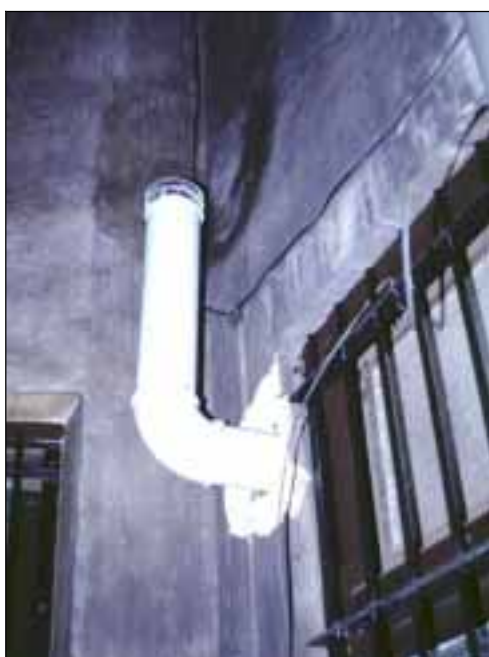
Foto 62A: Evacuación por fachada de caldera atmosférica, el tramo exterior ha sido prolongado 50 cm, conforme a los requisitos del RIGLO.
