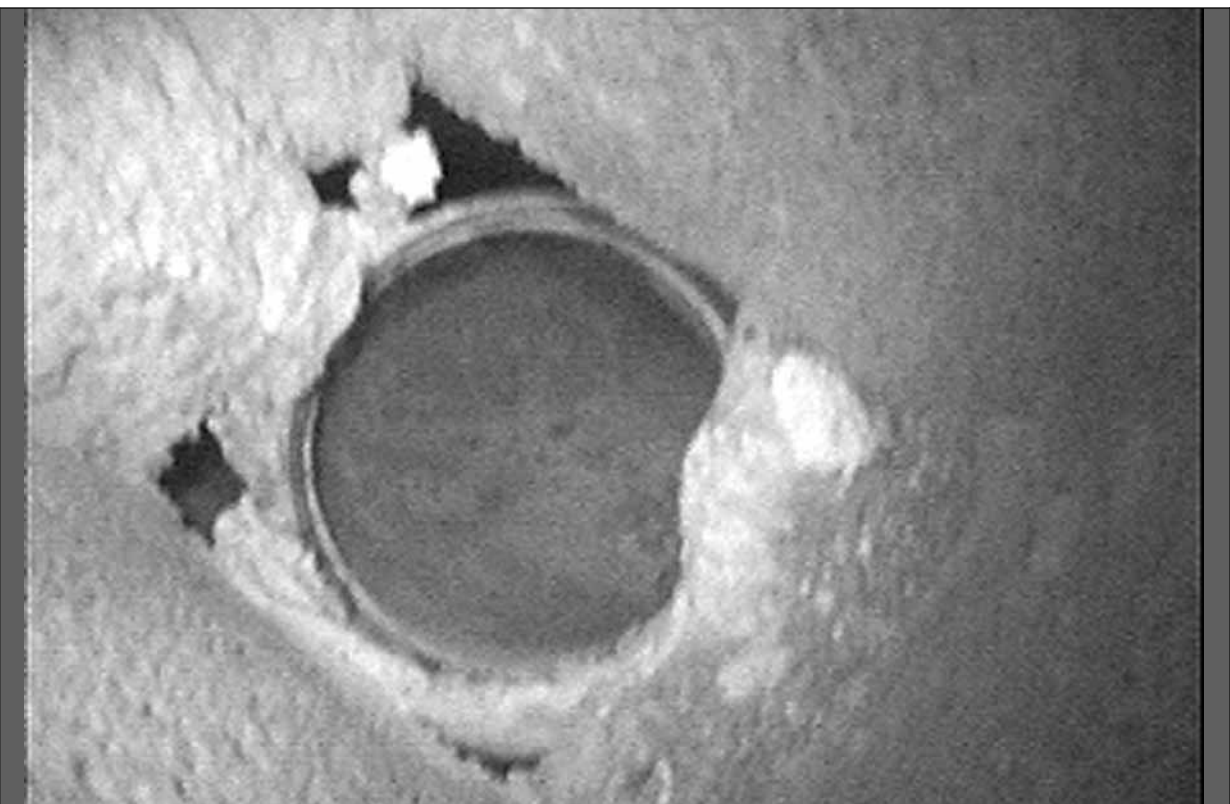
Foto 32: Conducto de evacuación de humos embocado si asegurar la estanqueidad, además de hacerlo por la parte inferior de la chimenea sin permitir el tramo en fondo de saco que evite el riesgo de obstrucciones.
