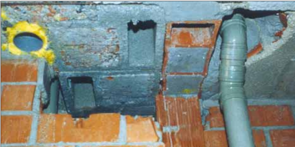
Foto 36: Conexiones de los conjuntos de ventilación en planta baja; en el centro la correspondiente a las chimeneas con material de hormigón según ISH, junto a ella la de ventilación de cocinas con material ISV y a la izquierda con conducto circular de PVC el correspondiente a la campana extractora. La chimenea arranca del techo de la planta baja, cuando debiera hacerlo desde el suelo de la misma, con el fin de disponer de un fondo de saco para el conducto común, con el correspondiente registro de limpieza
