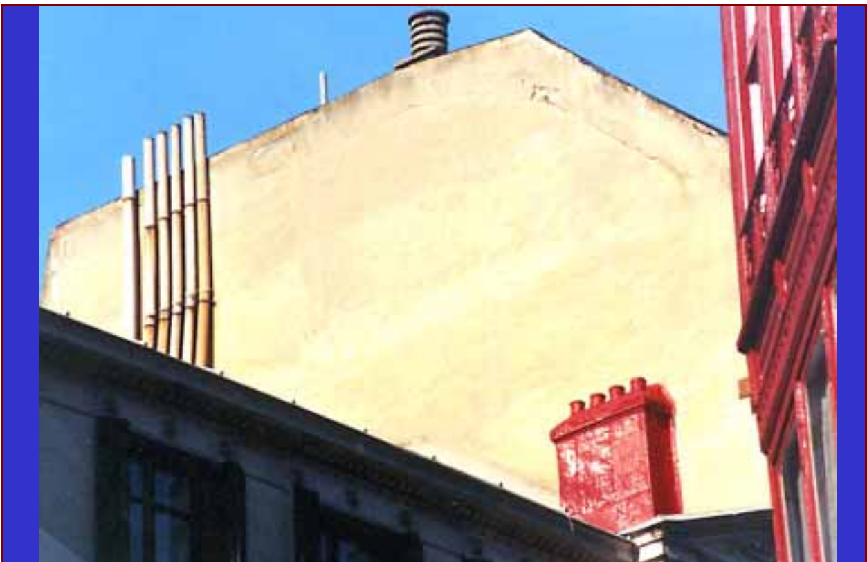
Foto 21: Chimeneas individuales de obra de fábrica; uno de los conjuntos ha sido elevado adecuadamente al realizar la construcción contigua, mientras que el otro ha quedado excesivamente bajo.
