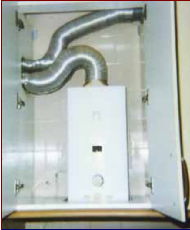
Foto 25: Conducto de Humos de material inadecuado (Aluminio Flexible) y trazado con pendiente negativa y muy sinuoso, Absolutamente Inadmisible.
