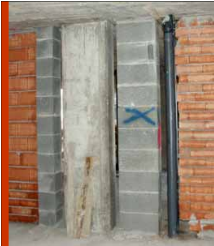
Foto 10: Chimeneas Colectivas de hormigón; material adecuado para Humos conforme a la norma NTE-ISH/74
