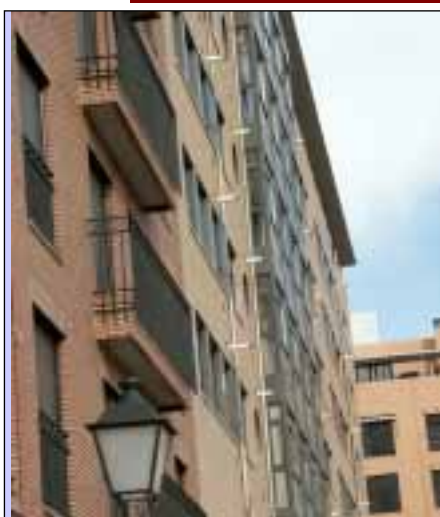
Foto 15B: Edificio de nueva construcción con evacuación de humos por fachada exterior. Al margen de consideraciones estéticas en este caso se produce la evacuación en una fachada con gran número de ventanas, lo que incrementa el riesgo de molestias entre usuarios.
