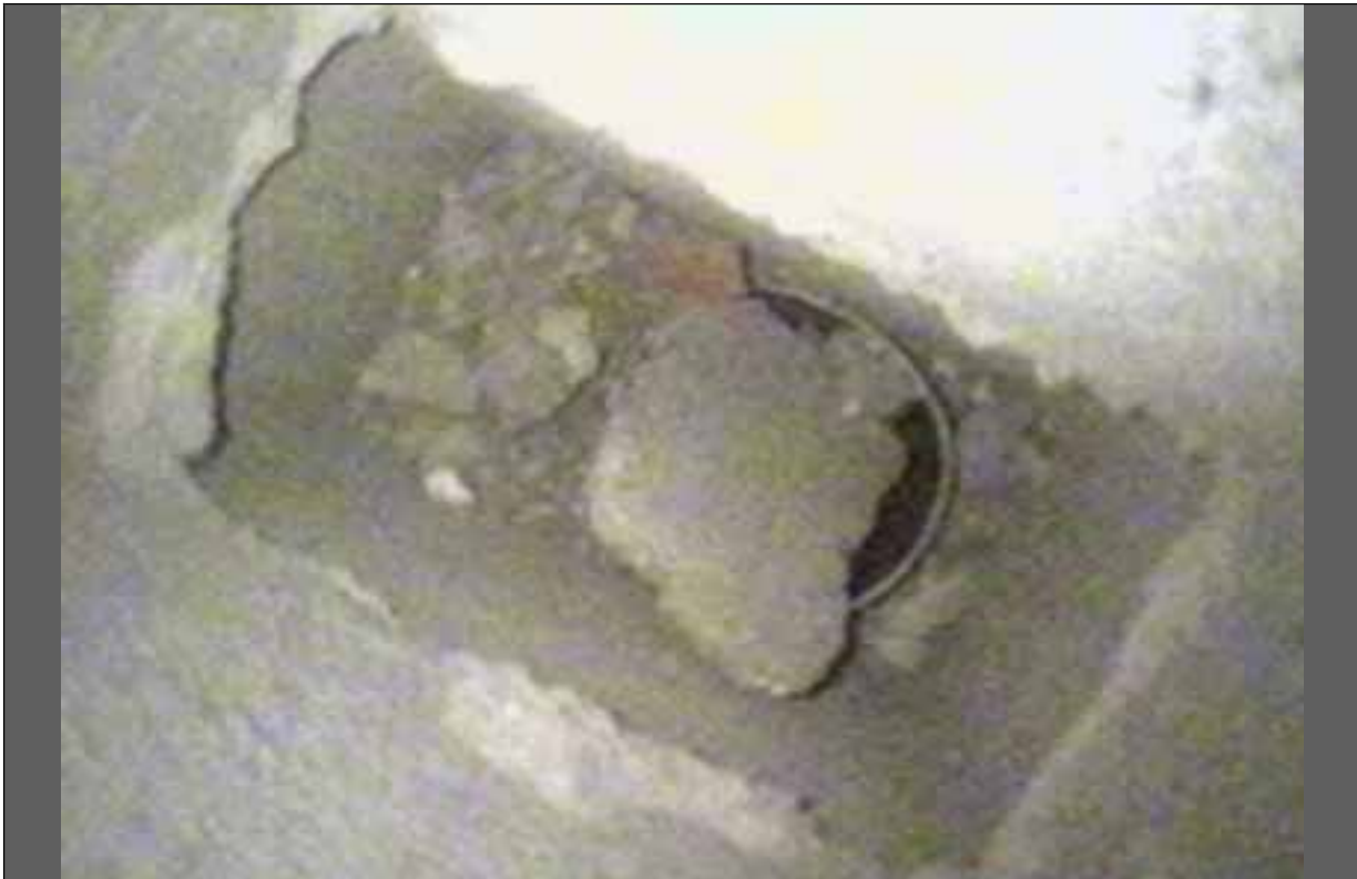
Foto 9: Obstrucción, por materiales de obra, del Conducto de Evacuación de Humos, debido a no haberse realizado el arranque de la chimenea en “Fondo de Saco” y el entronque del conducto por el lateral de la chimenea, como indica la norma UNE 123.001.
