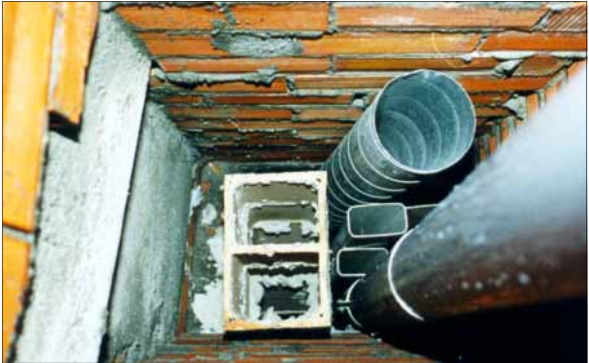
Foto 43: Edificio de 4 plantas; la salida conjunta de las ventilaciones de cocinas, extractoras y bajante de saneamiento, con la chimenea, la cual no alcanza la base del aspirador estático. La chimenea es de material inadecuado (ISV) y presenta abundantes restos de masa, además, carece del conducto individual correspondiente a la última planta.
