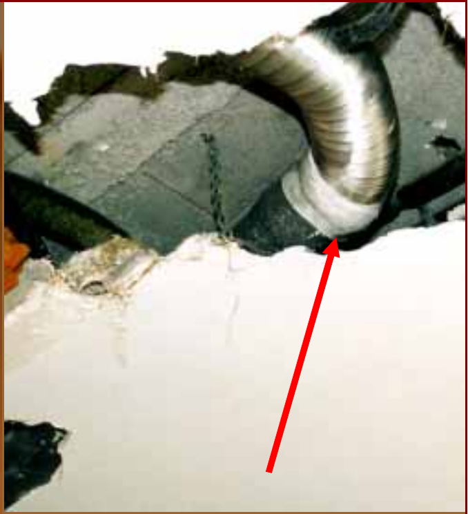
Foto 28: Conducto de evacuación de humos de material inapropiado (Aluminio Flexible) conectado a otro conducto de PVC, antes de su entronque a chimenea.
