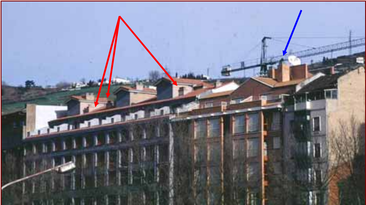
Foto 20: Remates en cubierta de chimeneas y ventilaciones; en el edificio de la izquierda han quedado por debajo de los casetones de los ascensores, en el de la derecha han sido correctamente elevados
