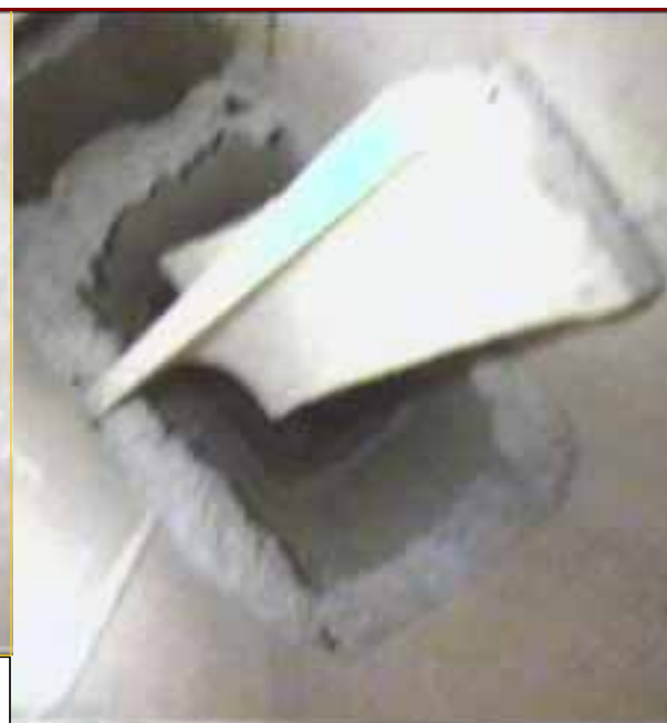
Foto 19: Chimenea correspondiente a un edificio de 4 plantas. Material inadecuado ISV y conducto obstruido por restos de material de obra.
