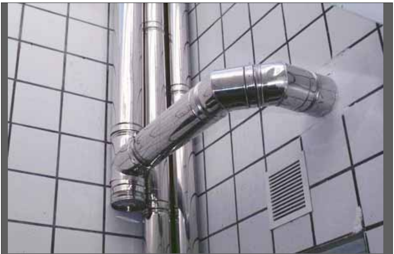
Foto 67B: Chimeneas de Acero Inoxidable de SIMPLE pared; esta fue la solución adoptada para las tres últimas plantas del edificio de la Foto 41, el conducto cerámico se reutilizo para las dos primeras plantas, si bien el material cerámico era ISV, no adecuado.
