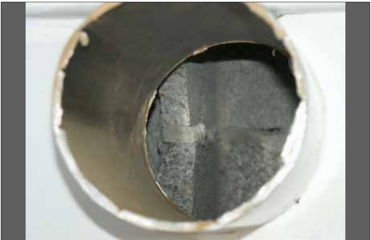
Foto 14: Emboque a Chimenea Colectiva de Hormigón (NTE-ISH/74), reducción de la sección de emboque por no haber utilizado la pieza adecuada ISH-9, en este caso se han puesto en contacto los conductos auxiliar y común.
