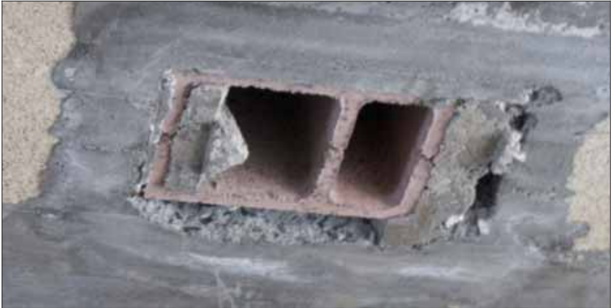
Foto 52: Chimenea de Obra (ISH), abierta en su parte inferior en el Local Comercial, esta abertura provoca una entrada de aire parásito que perjudica al tiro; además puede llegar a ser utilizada en el Local Comercial, lo que no está permitido, por mezclar diferentes usos.
