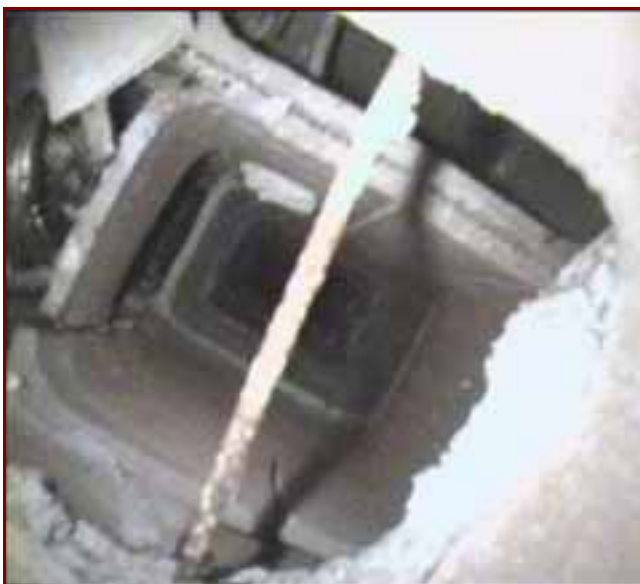
Foto 18: Chimenea correspondiente a un edificio de 4 plantas. Conducto roto en comunicación con el correspondiente a las campanas extractoras; en la izquierda se observa la conexión de la caldera realizada con aluminio flexible e incorrectamente embocada.
