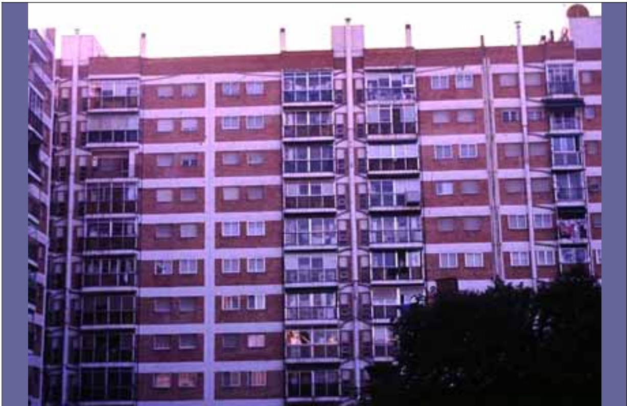
Foto 65A: Evacuación por cubierta en edificación existente, si bien el material no es adecuado, conductos de evacuación de humos de aluminio flexible y chimeneas de fibrocemento, resulta una mejora importante sobre la evacuación por fachada.
