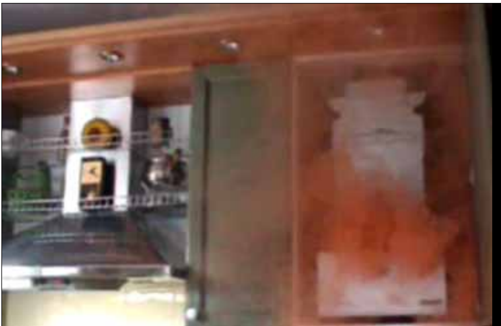
Foto 5: Revoco de humos provocado por el funcionamiento conjunto de la campana extractora y la caldera atmosférica, ensayo realizado con humo trazador, por NATURGAS y el Departamento de Máquinas y Motores Térmicos de la UPV.
